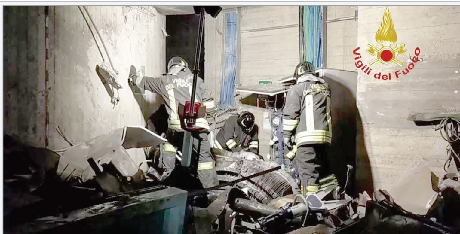
I Vigili del fuoco impegnati nella centrale dell'Enel a Suviana
